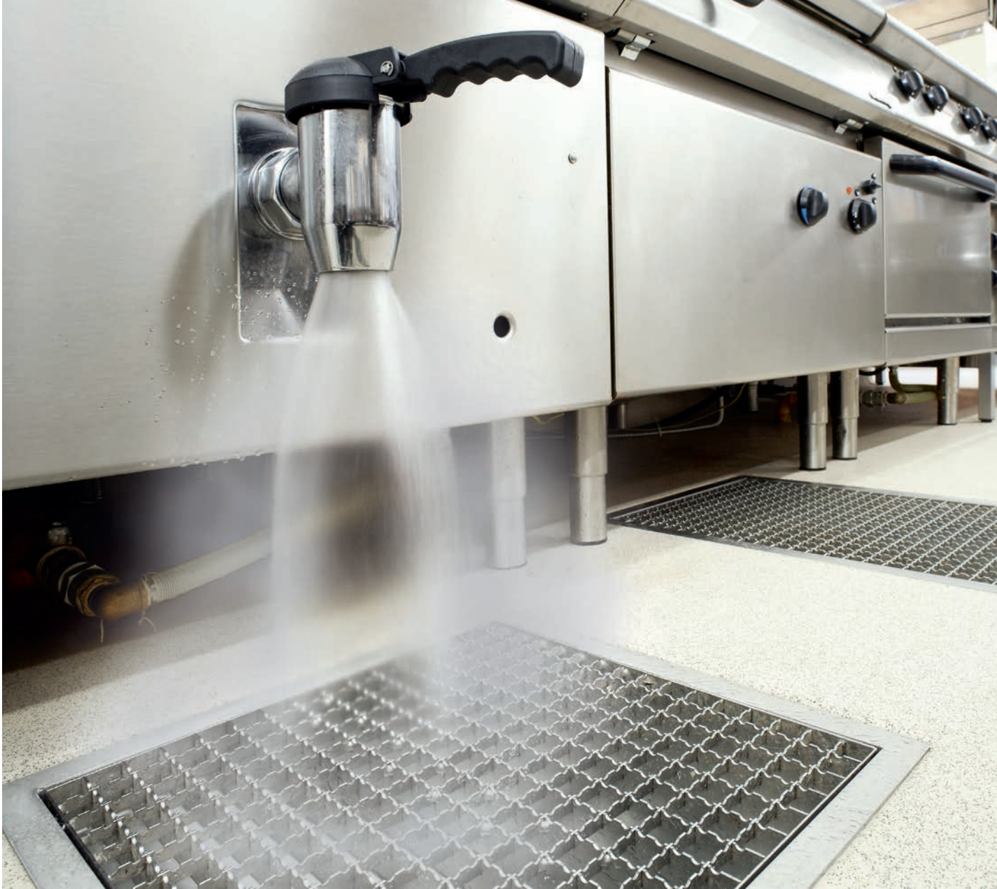
Entleerung eines Kochkessels
